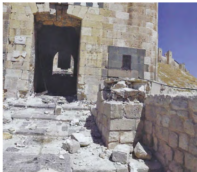
Рис. 2: Разрушение входа в Цитадель.
